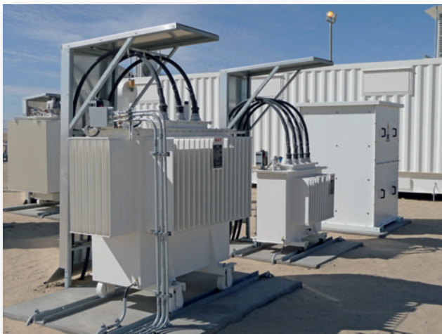
Kompletanlage 24 kV Sternpunktbildner und Erdungswiderstand 200 A, 10 sec. Kompensationsdrossel 1500 kVAR
