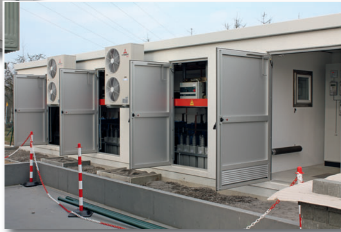
Betonstation 12 x 3 m mit Klimaanlage
