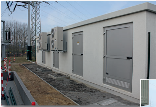
Mittelspannungskompensation 20 kV, 3x 4,6 MVA r , 7% verdrosselt
