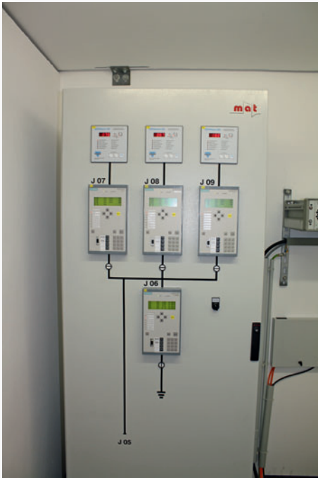
36 kV Leistungsschalter mit Siprotec Schutzgeräten
